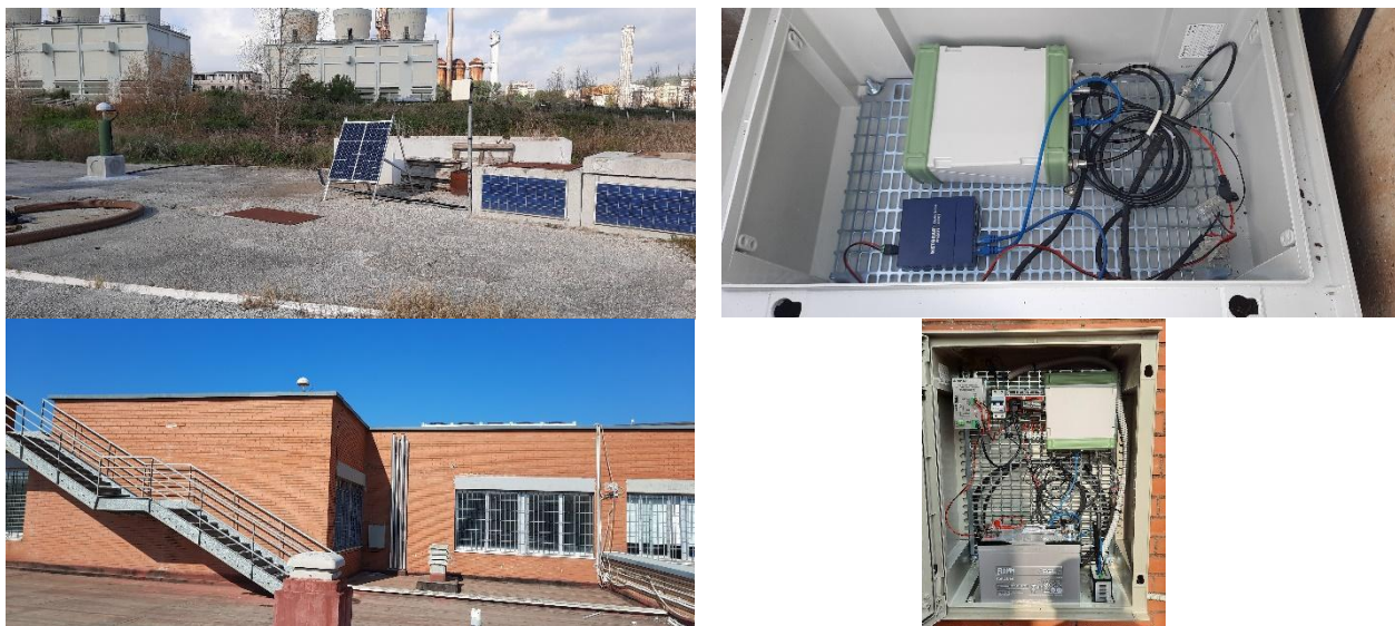
Figura 2.1.2 - Alcune stazioni GNSS di nuova installazione nel 2023 (BAAC in alto e MITT in basso)
