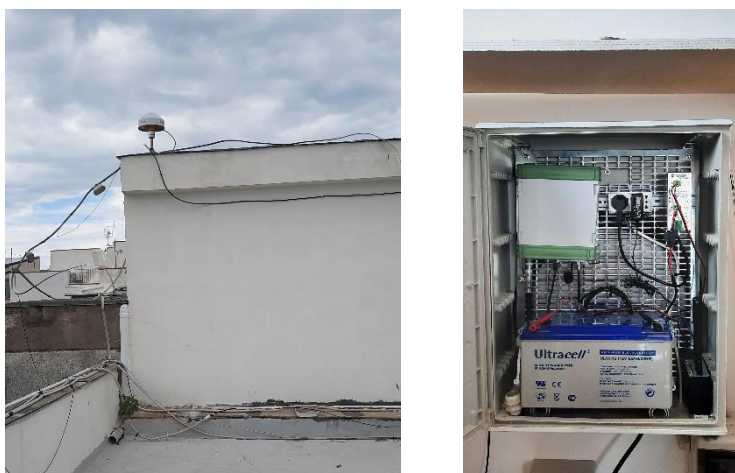
Figura 2.1.2 Ristrutturazione e upgrade GNSS della stazione di I PRO (Procida) eseguito nell'aprile 2023.
