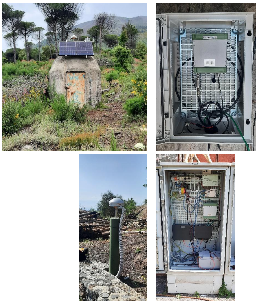
Figura 2.1.2 - Alcune stazioni GNSS di nuova installazione nel 2023 (BKSU in alto e TREC in basso)
