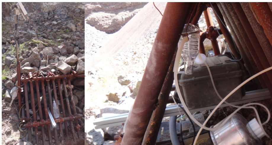
Figura 4.4 - Installazione della nuova stazione geochimica in area di fondo cratere. La particolare struttura è necessaria per difendere la stazione da possibili eventi franosi.
