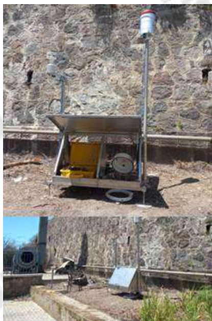
Figura 4.19 - Stazione geochimica installata il 19 maggio 2026 presso l'Istituto Professionale "Lucio Petronio" per la misura del flusso di \text{CO}_2 dal suolo, delle temperature del suolo e dei parametri atmosferici.
