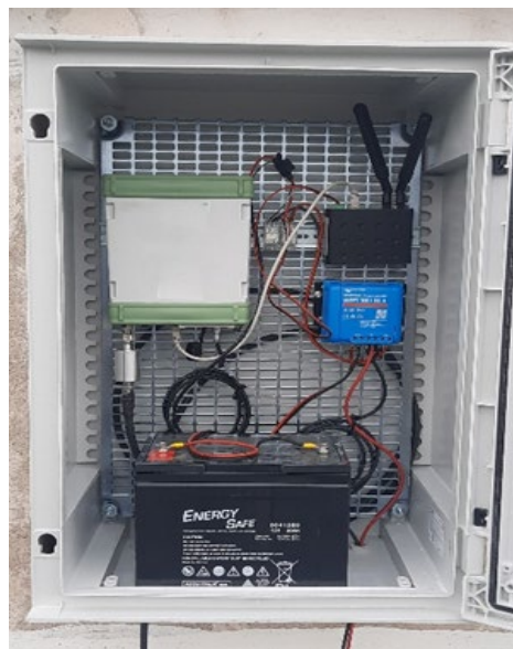
Figura 2.1.2 - Stazione GNSS PALM (Palma Campania) installata a dicembre 2024.
