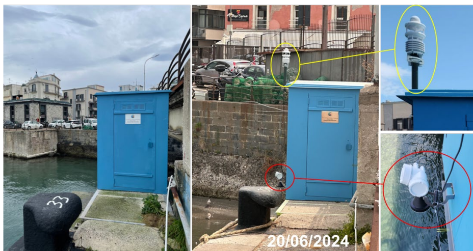
Figura 2.3.4 – Il nuovo sensore digitale radar e la stazione meteorologica installati alla stazione di Pozzuoli Porto (POPT).
