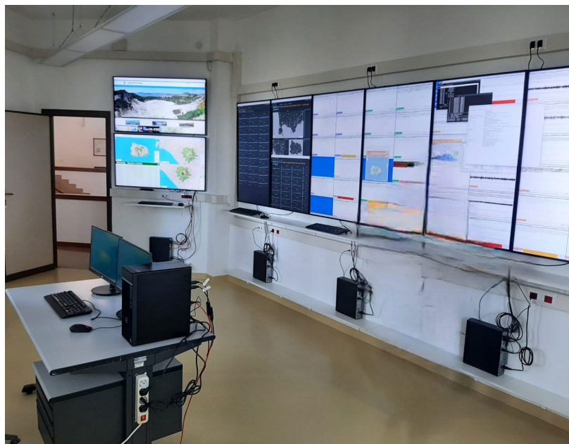
Figura 2.2 - La Sala di Monitoraggio di ridondanza alla Sede Storica dell'Osservatorio Vesuviano durante la sua installazione.
