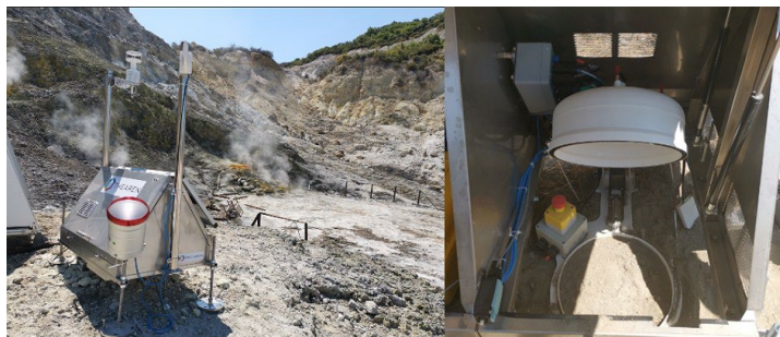
Stazione geochimica multiparametrica alla Solfatara
