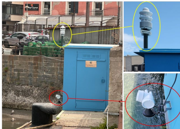
Sensore digitale radar e stazione meteorologica alla stazione mareografica del Porto di Pozzuoli
