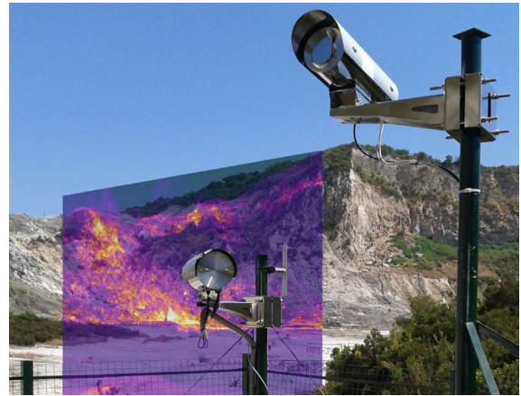
Stazione a doppio sensore della rete permanente all'infrarosso termico TIRNet alla Solfatara
