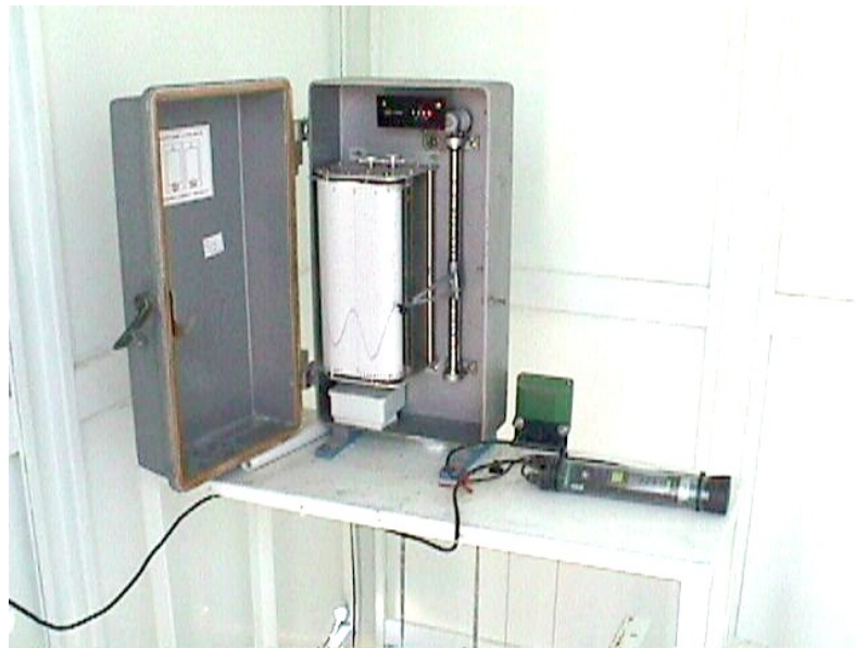
Figura 5 Interno di una cabina mareografica.
